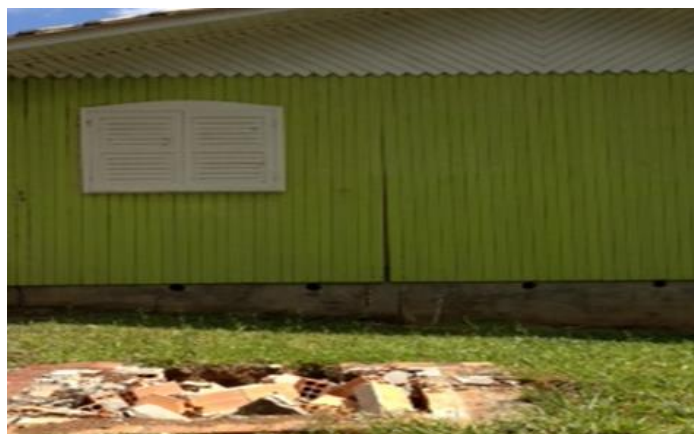
FOTOGRAFIA 6 - Rachaduras em residência decorrente da subsidência
